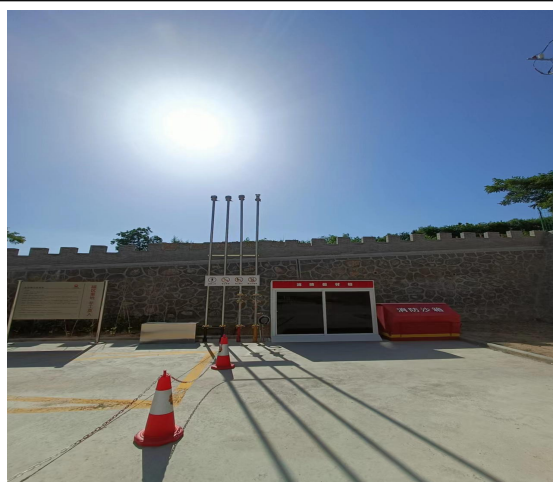
通气管及消防器材箱
