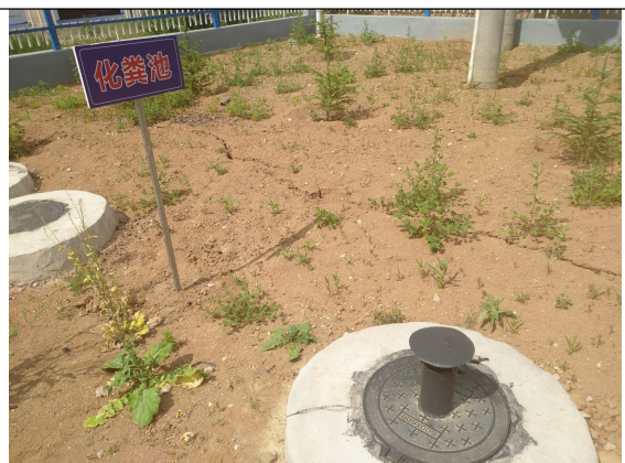
调节池 (化粪池)
