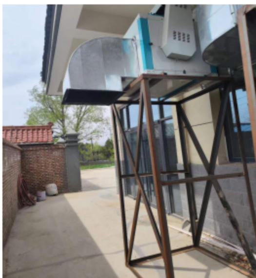
油烟排气筒 (DA001)
