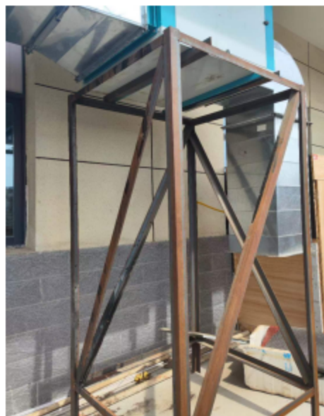
油烟排气筒 (DA002)
